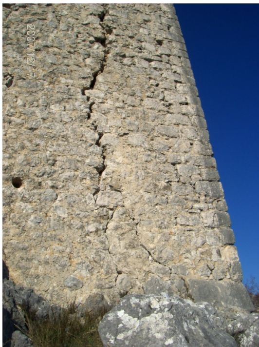
Izražena pukotina na zidu 2- pogled sa vanjske strane
