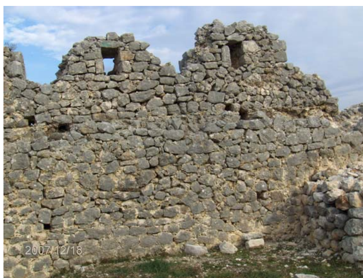
Prikaz oštećenja krune zidova
