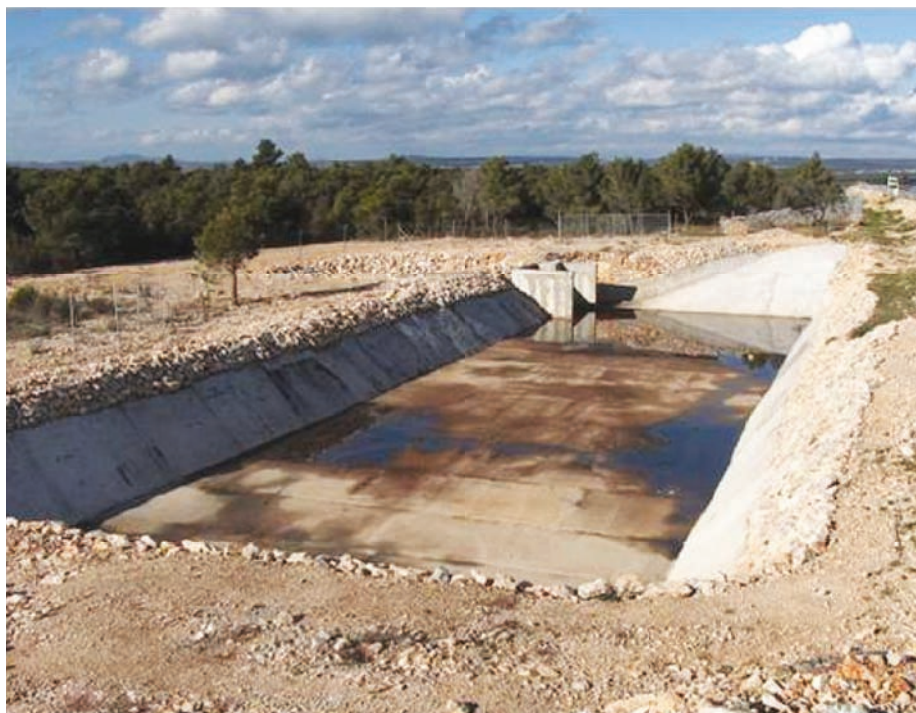
Slika 1. Laguna za pročišćavanje otpadnih voda
