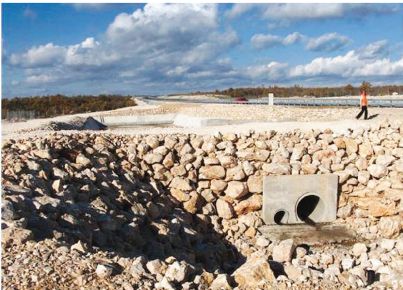
Slika 3. Ispust za pročišćene otpadne i oborinske vode
