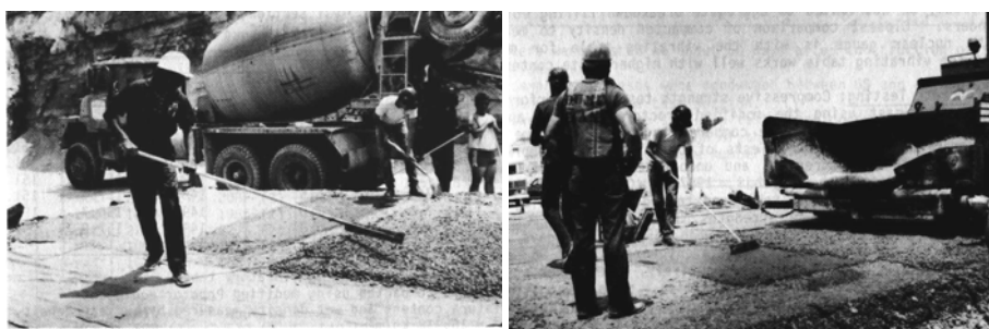
Sl. 3a) nanošenje kontakt-betona, uz prethodno čišćenje zrakom površine UB b) nanošenje tekuće mješavine cement-pijesak
