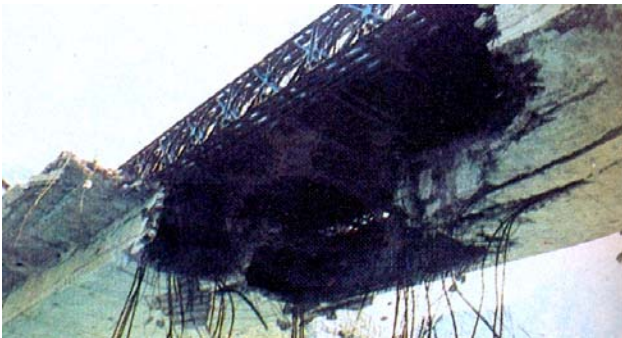
Slika 10. Oštećeni most preko akumulacije HE Grabovica u Aleksin Hanu
