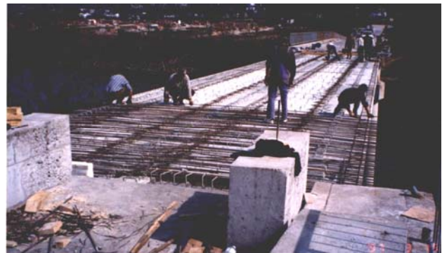
Slike 11.-12. Pogled na srušeno četvrto polje mosta (lijevo); sanacija četvrtog polja (desno)
