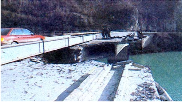
Slika 9. Oštećeni most u Aleksin Hanu
