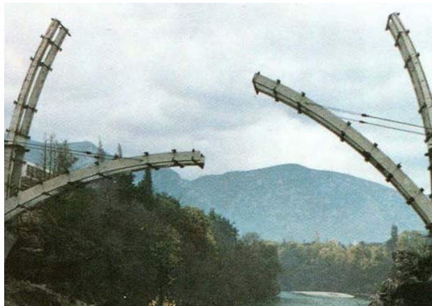
Slika 33. Prikaz građenja većeg luka pri obnovi mosta – tehnologija zakretanja predgotovljenih lukova (foto)
