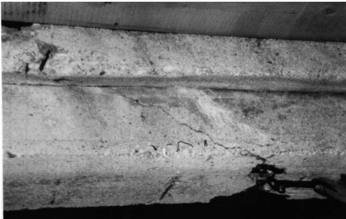
Slika 7. Dijagonalna pukotina na okvirnom nosaču br. 7
